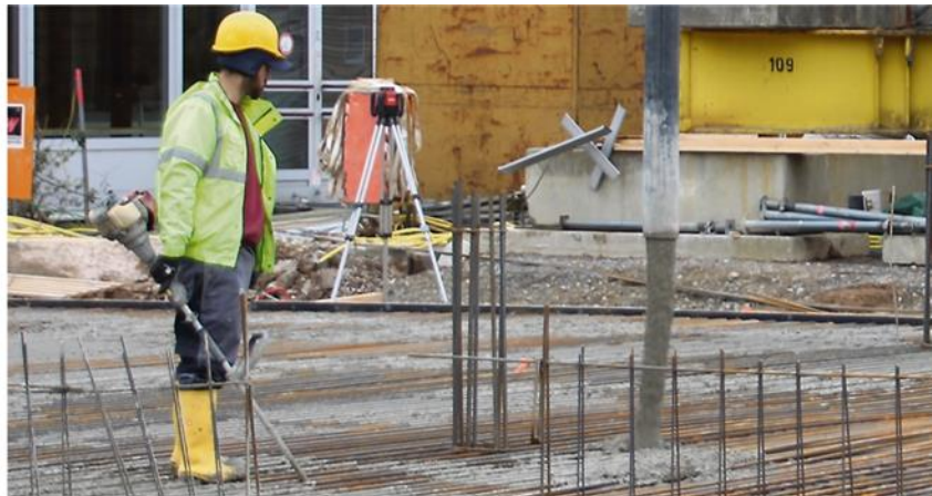
Auf der Baustelle geht es planmäßig weiter. Dort wurde jetzt die Bodenplatte gegossen.
